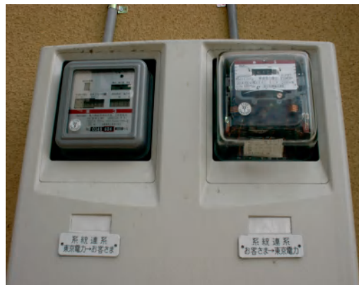
電力量計 余剰電力電力量計
